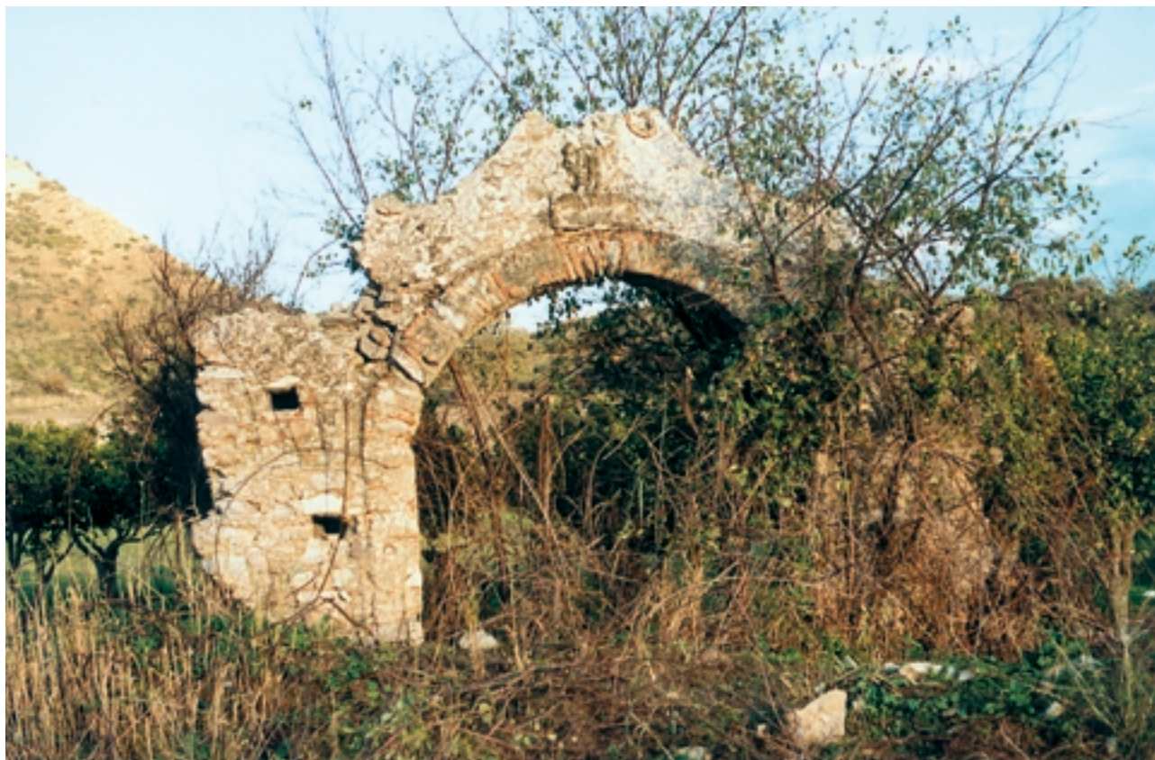
Contrada S. Gata: portale in muratura della recinzione del giardino, costruito nel 1609 [Foto G. Tallarico]
